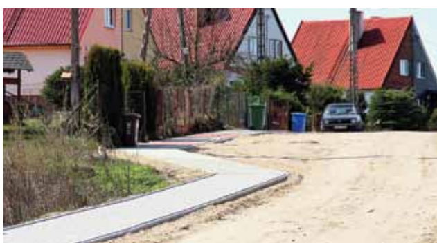
Budowa chodnika w miejscowości Bronisze. Chodnik został wykonany dzięki dotacji z budżetu państwa w wysokości 32 145,00 zł. Koszt: 36 112,74 zł.
